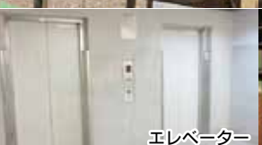
エレベーター
